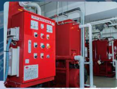
消防機電設備
